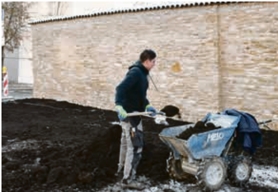
Leon Diegmann bringt auf der Stadtring-Seite des sanierten Stadtmauerabschnittes Erde auf die Freifläche. Später soll hier wieder Rasen grünen.
